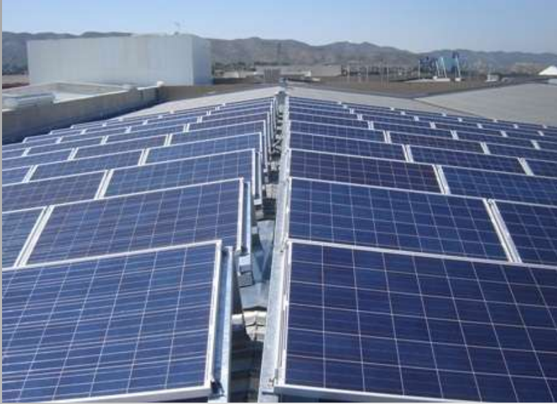
INSTALACIÓN FOTOVOLTAICA DE 24 KWp EN ONTINYENT (VALENCIA) POTENCIA 20 KWn / 24 kWp
